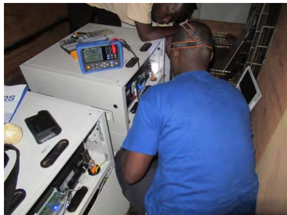
Figure 17: Les armoires des batteries
