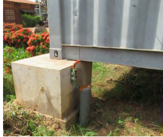
Figure 9: Borne de mise à la terre du local
