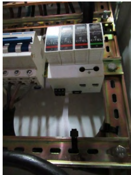
Figure 19: Parafoudre non relié à la terre
